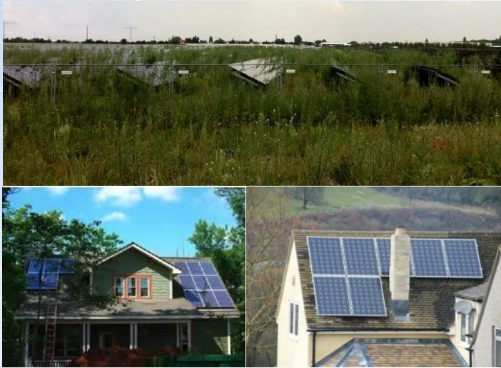
รูปที่ 5.18 ตัวอย่างการติดตั้งแผงเซลล์แสงอาทิตย์ในที่ที่มีเงาบัง และการไม่ดูแลรักษาพื้นที่
