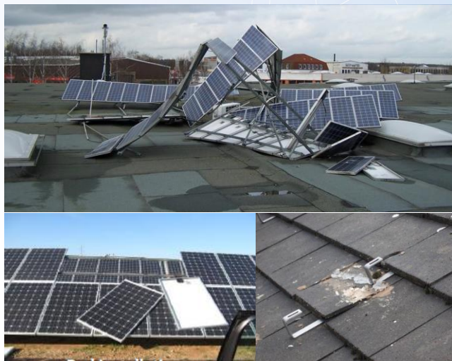
รูปที่ 5.17 ตัวอย่างการเสียหายที่เกิดจากการติดตั้งแผงเซลล์แสงอาทิตย์ [26]
