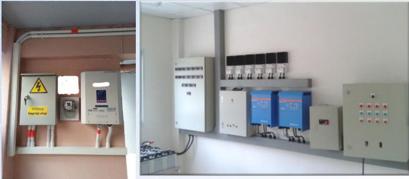
รูปที่ 5.9 ตัวอย่างการติดตั้งอุปกรณ์แปลงผันไฟฟ้า ตู้ไฟฟ้า และมิเตอร์ ในอาคาร (ภาพจากศูนย์ฝึกอบรมปฏิบัติการด้านการจัดการพลังงาน (Mini plant) กองพัฒนาทรัพยากรบุคคลด้านพลังงาน กรมพัฒนาพลังงานทดแทนและอนุรักษ์พลังงาน กระทรวงพลังงาน)
